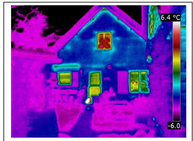
Een woning met op de eerste verdieping een beduidend mindere kwaliteit isolerend glas
